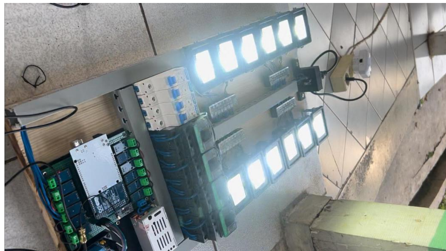
Gambar IV. 33 Kondisi Lampu Kontrol Jarak 100 Meter Sumber : Penulis
