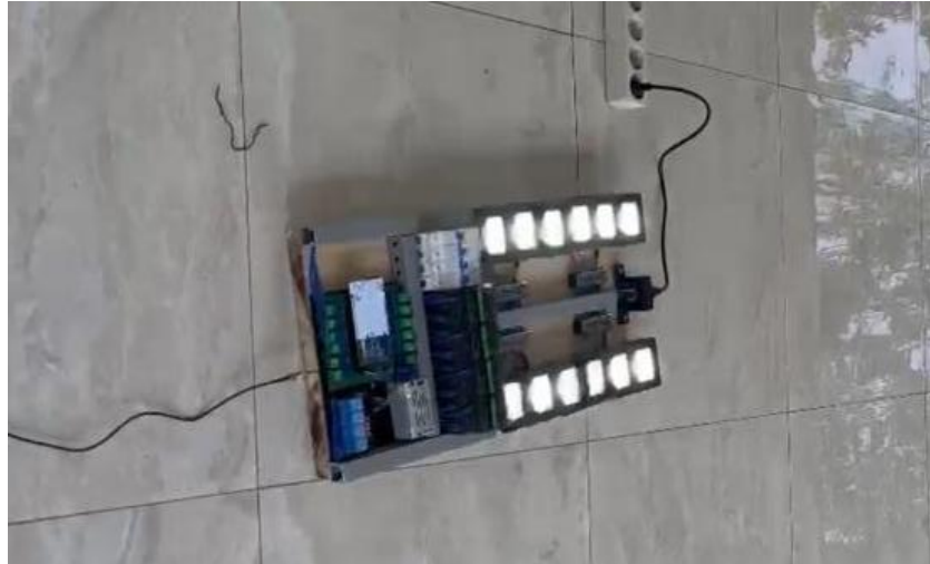
Gambar IV. 35 Kondisi Lampu Kontrol Jarak 150 Meter Sumber : Penulis
